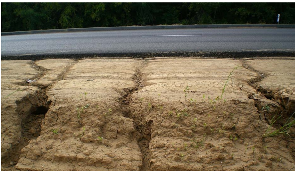
Рис.3. Образование промоин на неукрепленной грунтовой насыпи автомагистрали близ г. Петропавловска
